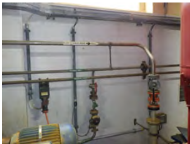
L'installation en question
