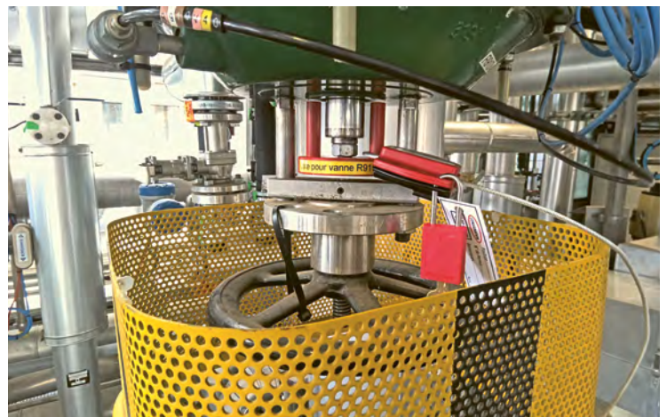
La cale sur chaudière.
